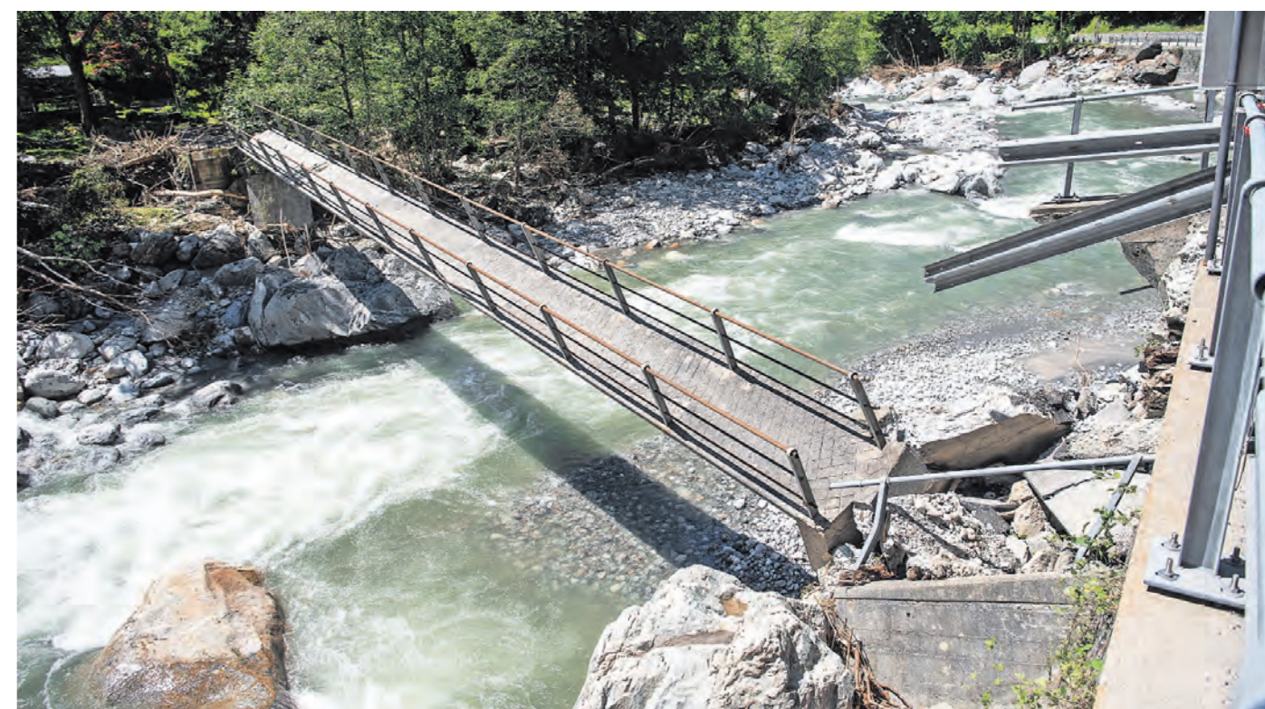
Uno dei numerosi ponti distrutti dal maltempo in Vallemaggia.
